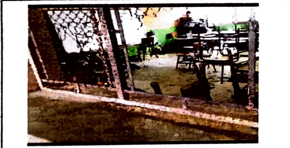
Foto 3: Se necesita de cambio de seis ventanas de un aula
